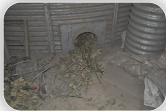
Feuilles de laurier dans les gaines de ventilation
